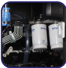
Filtro separador de partículas de combustible
